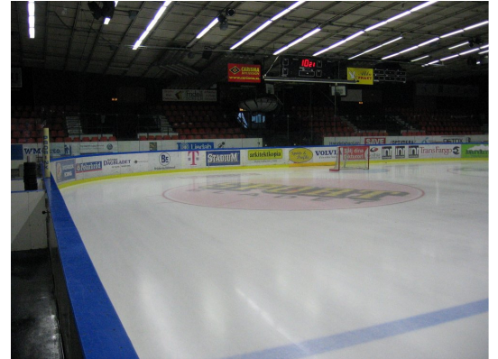
Malmön jäähalliin Ruotsiin on asennettu REALice™-järjestelmä
