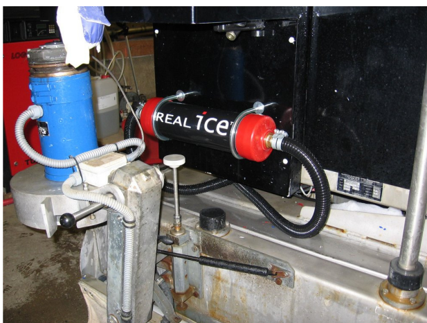
REALice™-järjestelmä asennettu Eisbear jääkoneeseen
